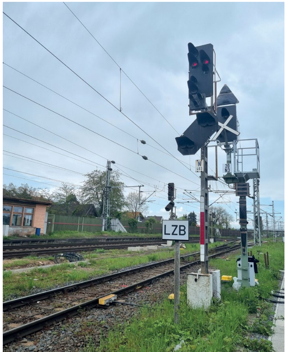
Abb. 2: Eines der neuen Ks-Signale im Bahnhof Gernsheim
