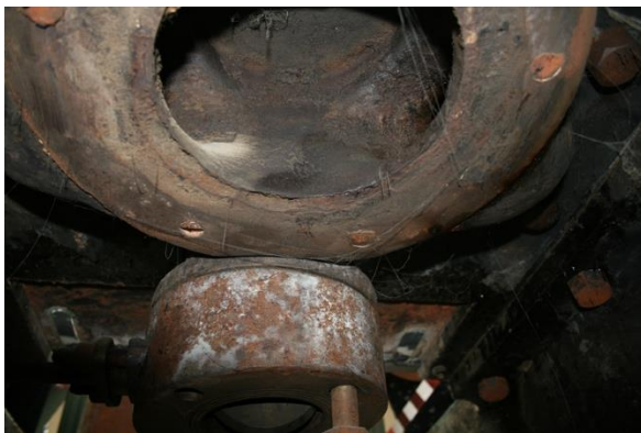
Figura 74: Escape al condensador (1)
