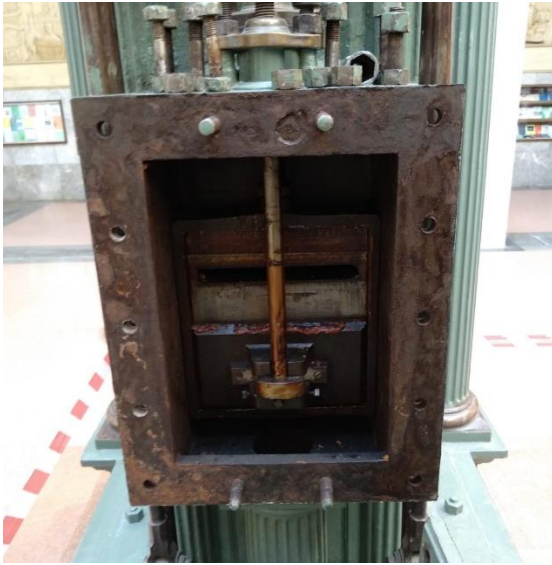
Figura 90: Interior caja distribuidora
