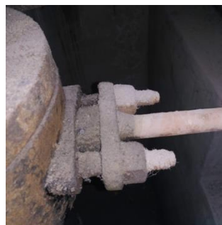
Figura 72: Conexión exterior con la válvula (2)
