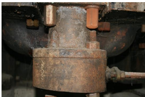
Figura 71: Tubería alimentación de vapor (1)
