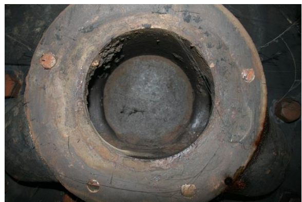
Figura 75: Escape al condensador (2)
