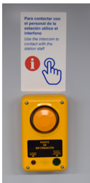
Interfono de estación
