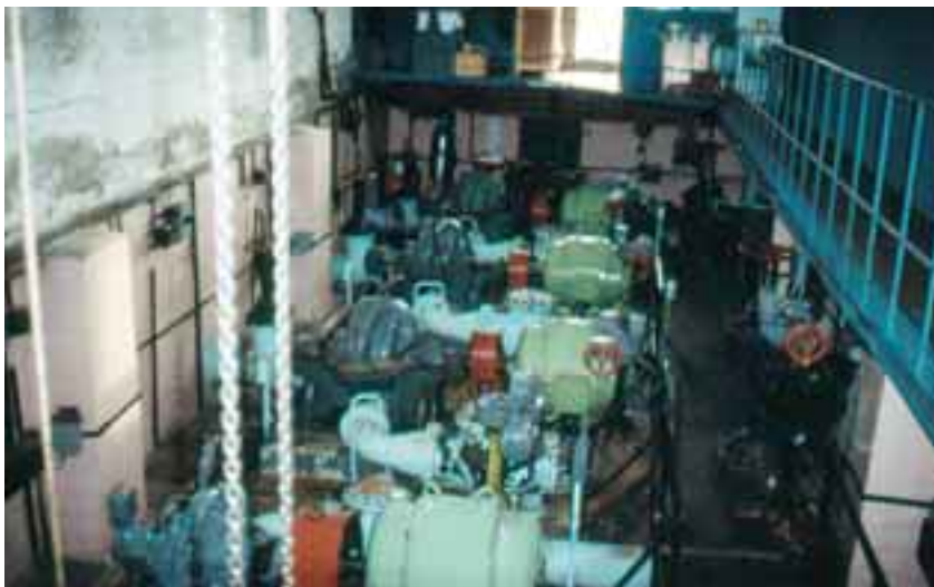
Kuva 2. Sisäkuva käyttöveden pumpptaamolta. Verkostossa olevat pumpptaamot toimivat ilman välisäiliötä nostamalla painetta esimerkiksi 2 at:sta 8 at:hen. Pumppuja käynnistetään ja pysäytetään tarpeen mukaan käsin. Yleensä pumpppujen yhteydessä on suuritehoiset moottorit, joista isoimmat (yli 500 kW) ovat ns. korkeajännitemoottoreita.
