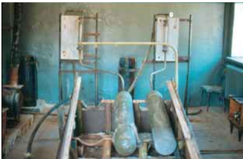
Suojärven kaupungin vesilaitoksen kloorinsyöttölaitteet vuonna 1995. (Kuva: Erkki Santala)
