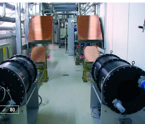
Abb. 21: Übertragungsleitungen: Die Mikrowellen werden quasi-optisch übertragen, umgelenkt werden sie durch spezielle Spiegel. (Foto: IPP)
