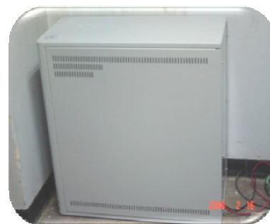
Figura No. 4- 7 . Unidades de sistema interrumpido de poder – (UPS)
