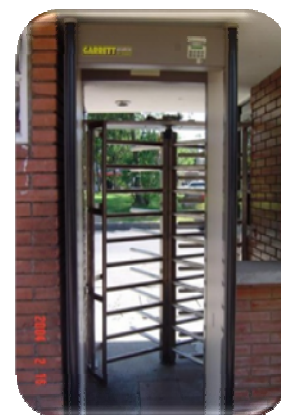
Figura No. 4- 10 . Detector de metales y trinquetes Establecidos en la entrada y salida del edificio de Oficinas Centrales
