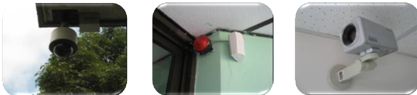
Figura No. 4- 9. Cámaras y domos instalados en la Industria Militar
