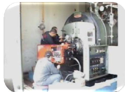
Figura No. 2- 14. Modificación de las calderas.
